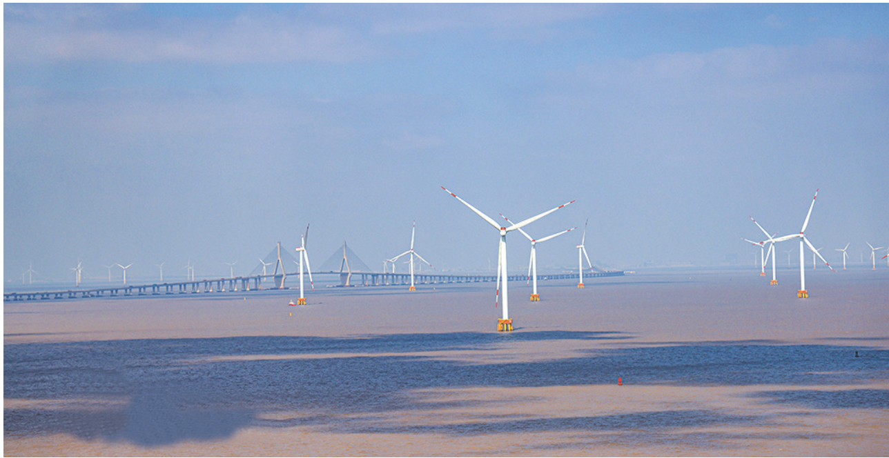
2月15日,上海东海大桥海上风电场在蓝天白云的映衬下美不胜收。上海东海大桥海上风电场位于上海浦东新区临港新城至洋山深水港的东海大桥两侧,是我国第一座海上风电场示范工程,也是亚洲第一座大型海上风电场。
